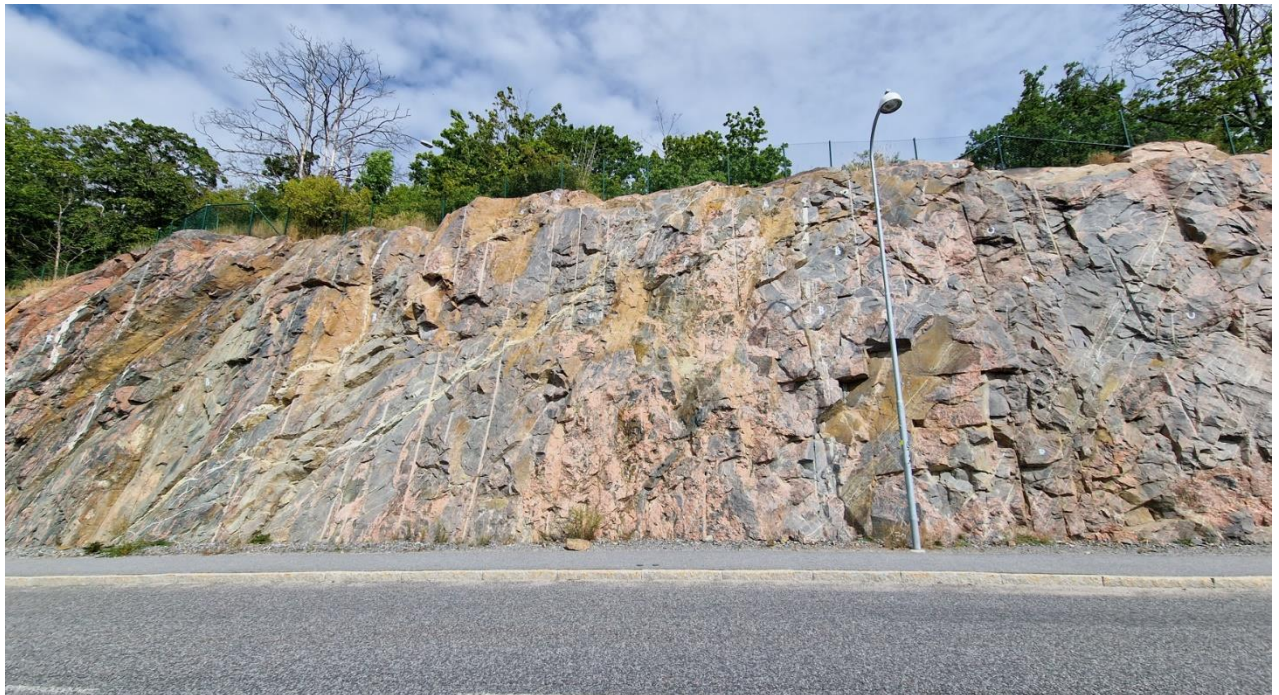
Figur 3. Översikt på framsprängd bergslänt längs Kvarnholmsvägen. Rost syns på sprickytor.
