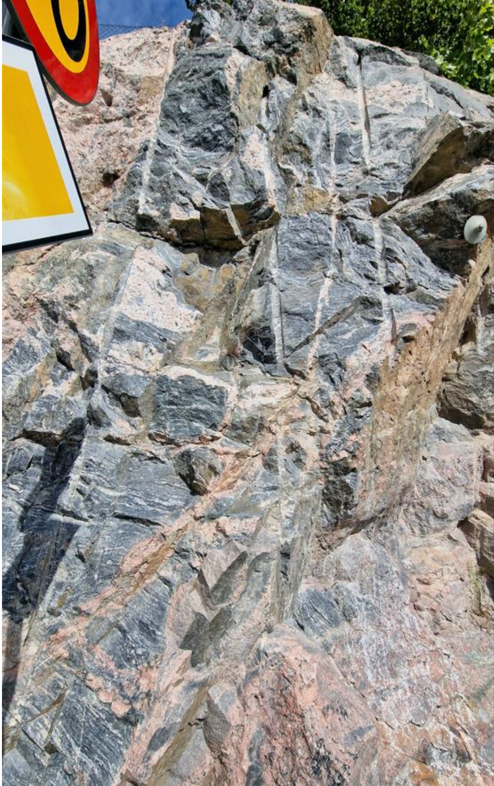
Figur 5. Mörkare granit med synligare struktur. Rost syns på spricktor.
